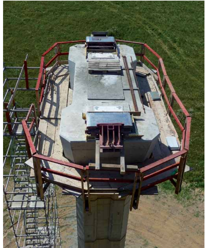
Klzné ložiská s bočným vedením na pilieri The sliding bearings and lateral guides on pillar
