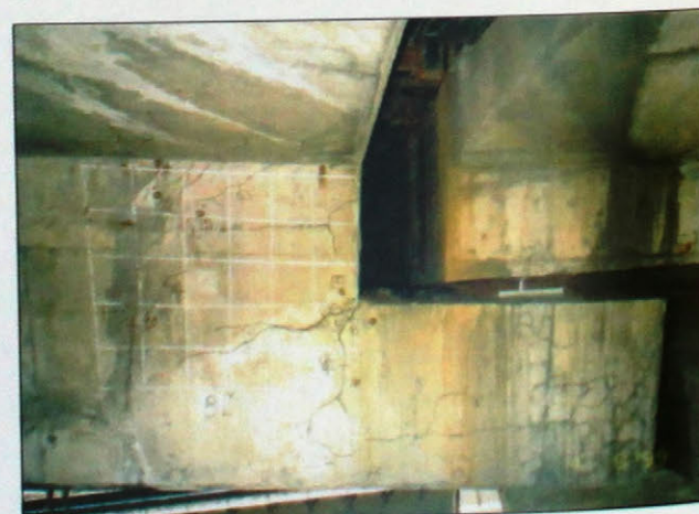
Obr. 3 Trhliny na dolnom ozube estakády Prístavného mosta - pohľad na ozub, trhliny a nerovnaké natočenie hornej a dolnej časti ozuba
