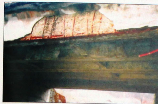
Obr. 2 Trám mosta poškodený rozpadom betónu a koróziou výstuže
