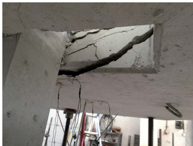
Obr. 5 Šmyková trhлина po porušení dosky D1-1 v mieste otvoru Fig. 5 Shear crack after failure of the slab S1-1
