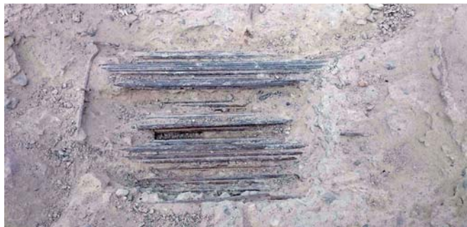
Obr. 3 Zdravé, ako aj vplyvom korózie pretrhnuté predpínacie dróty v blízkosti odvodňovača
