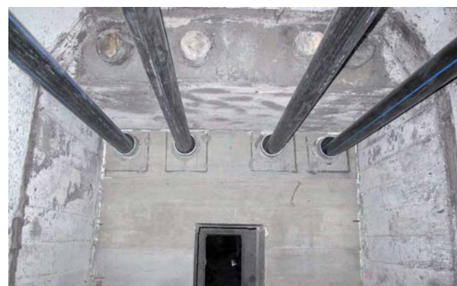
Obr. 8 Vedenie káblov v komore (betónový deviátor a nadpodperový priečnik) Fig. 8 External tendons in the box girder (concrete deviator and strengthened diaphragm over the pier)
