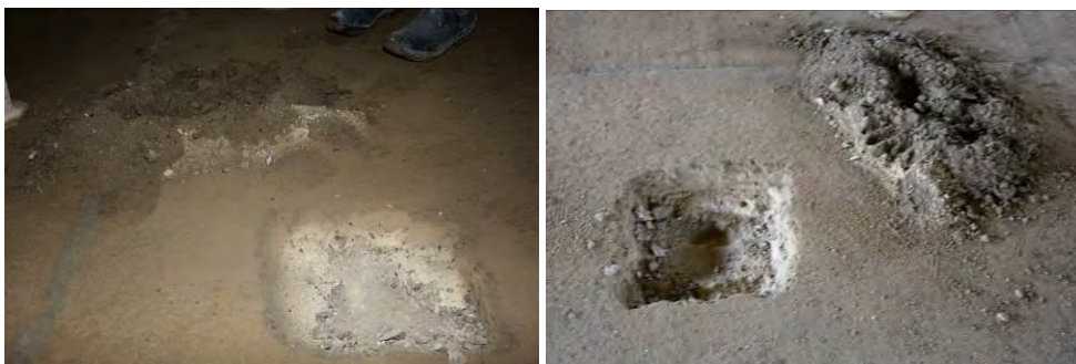
Obr.3 Poškodenie stropnej dosky s premrznutím
