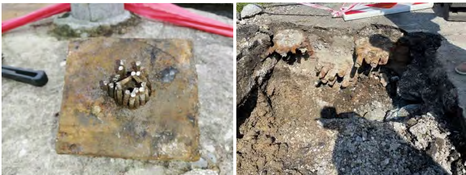
Obr. 4 – Detail odobratej kotvy (vľavo), kotevná oblasť (vpravo).
