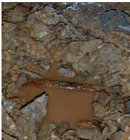
Obr. 3: Korodujúce predpínacie lano.
